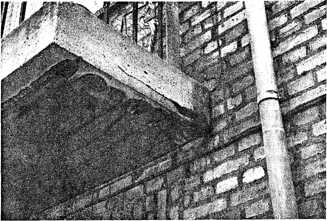
Fig. 16. Billedet viser en begyndende ødelæggelse af kanten af en betonplade. Revnen har allerede fået en vis udstrækning, og et stykke af den dækkende beton er faldet ud. — Altanpladen er ikke over 20 år gammel.
